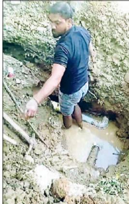
सोनीपत के मिशन रोड क्षेत्र में पुरानी पेयजल लाइन से कनेक्शन हटाने का काम चल रहा है। फोटो: हरिभूमि
